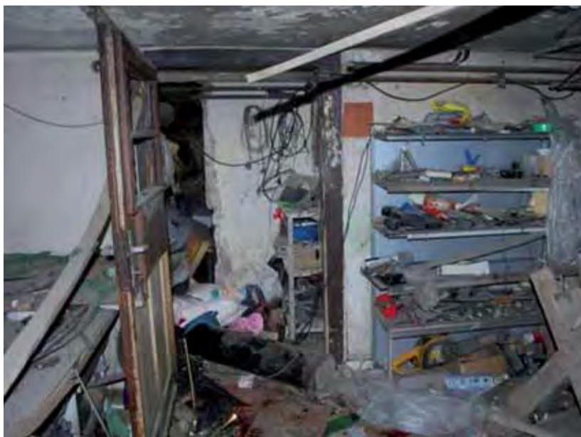
Pohľad na časť rodinného domu po výbuchu granátu.
